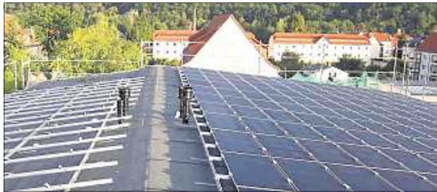
Fertig: Da stand das Gerüst der Sanierung in der Sommeritzer Straße 48 noch und bot die Möglichkeit der Montage der Photovoltaikanlage. Foto: Engo
